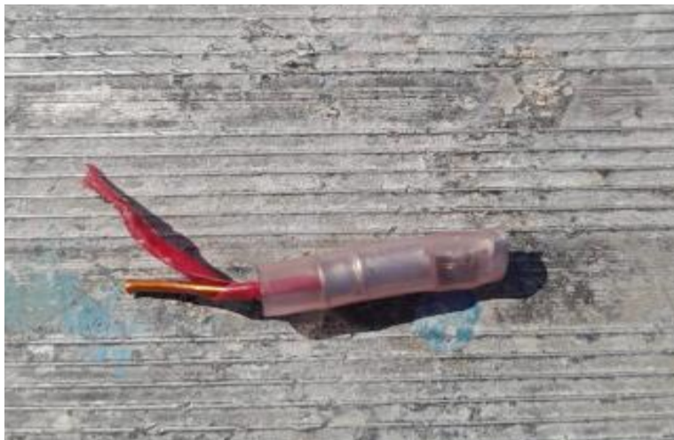
Imagen 5. Sección del cable dañado y removido YV3438.
