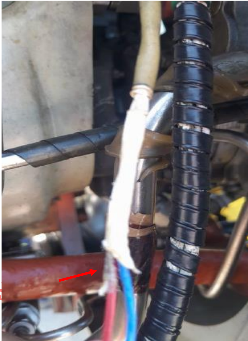
➤ Imagen 4. Cable dañado del conector de Torque Limiter Bypass Valve YV3438 .
