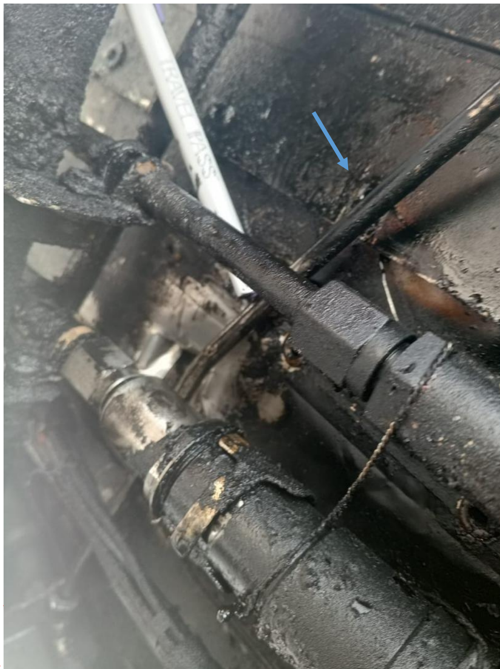
Figura 7. Tubería Hidráulica con fuga, Motor N°2 YV2792. Fuente: Investigadora Encargada. Año: 2026
