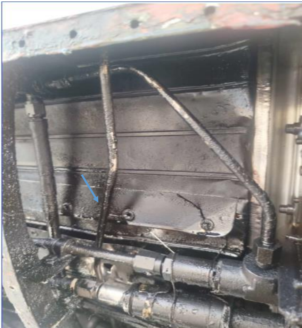
Figura 6. Tubería Hidráulica con fuga, Motor N°2 YV2792. Fuente: Investigadora Encargada. Año: 2026
