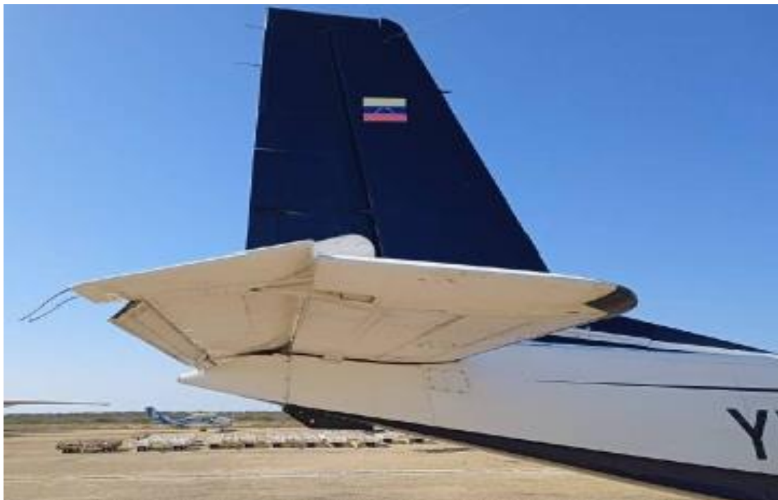
Imagen 7. Vista derecha del Empenaje sin daños YV2925.
