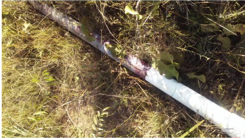
Foto 2. Poste del alumbrado de aproximación, que fue derribado por colisión del ala izquierda de la aeronave cuando realizaba aproximación final.
