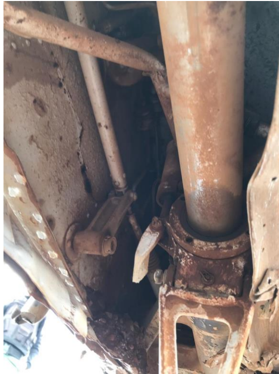
Imagen 8: Daños en la parte interior de la fosa del tren. Aeronave YV3162
