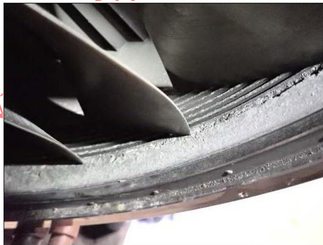
Imagen 37 Sello exterior del ventilador corroído Fuente: Fabricante Año: 2022
