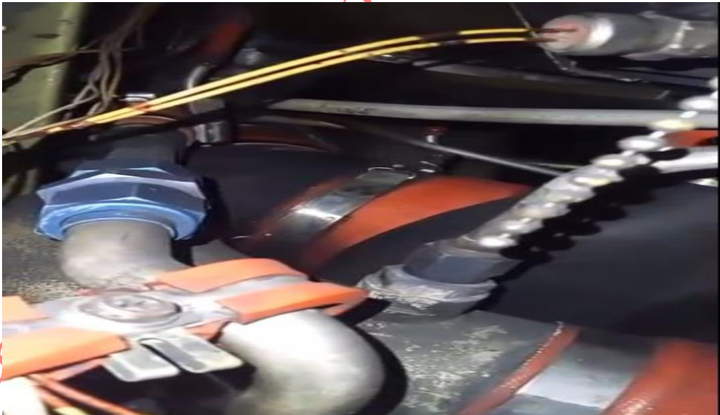
Figura 5: Inspección de fuga de aceite paquete Motor Derecho (RH) YV2923 Fuente: Investigador Encargado. Año 2026
