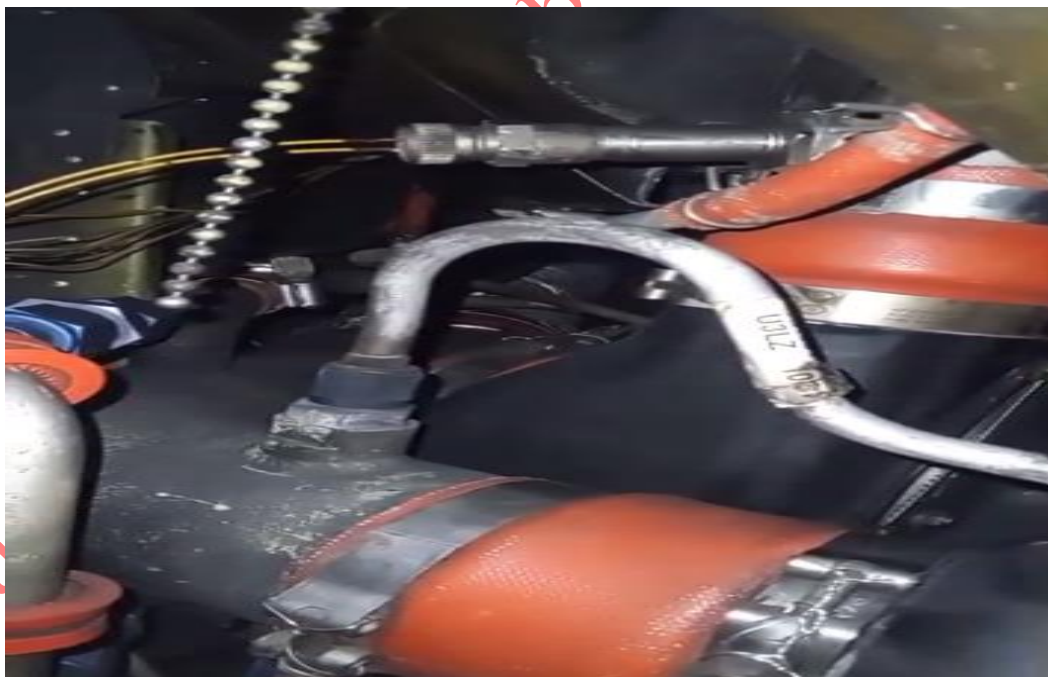
Figura 7: Inspección de fuga de aceite del paquete del Motor Derecho (RH) YV2923
