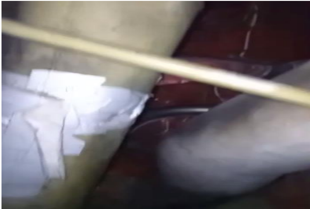
Figura 4: Inspección de fuga de aceite paquete Motor Derecho (RH) YV2923 Fuente: Investigador Encargado. Año: 2026
