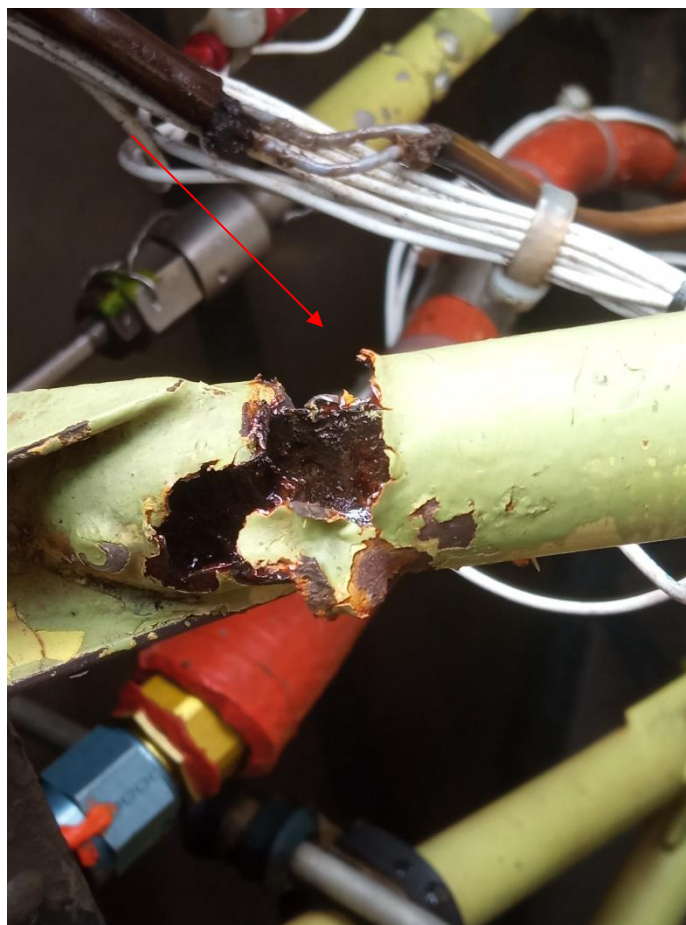
Fotografía 18. Daños montante del motor YVO211. Fuente: Investigador encargado. Año: 2024
