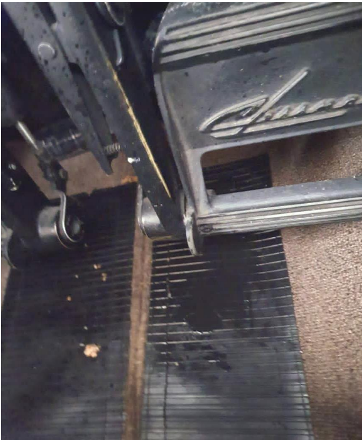
Figura 26. Fuga de Líquido hidráulico en los pedales FS 232 de la Aeronave YV2166 Fuente: Investigador Encargado. Año: 2023
