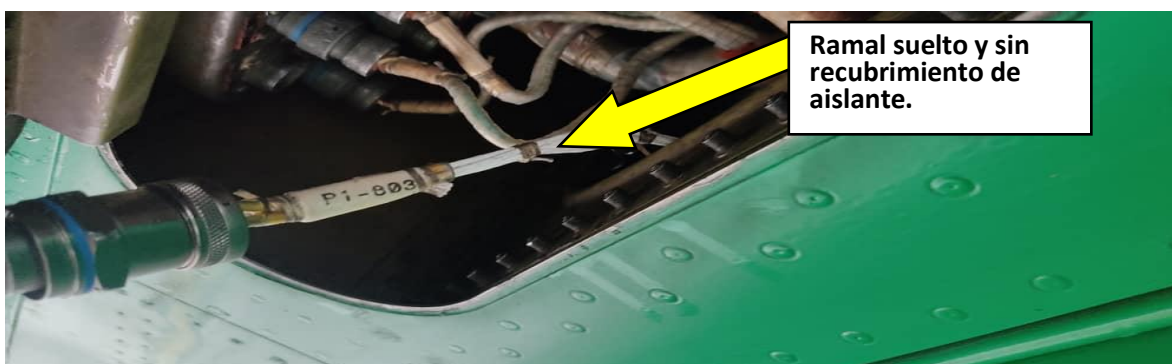
Figura 3. Ramal suelto y sin recubrimiento de aislante
