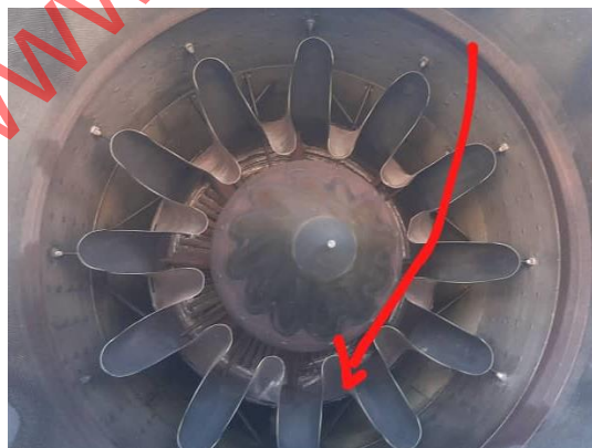
Fotografía 2. Daños en la turbina de baja
