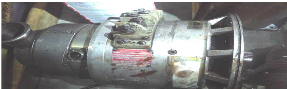
Figura 5. APU Del Motor Izquierdo instalado el 31/10/2022
