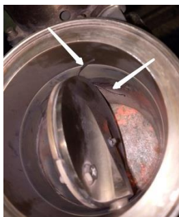
Fotografía 2. Daño en la Válvula de Sangrado
