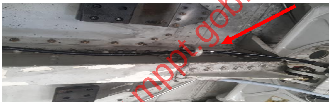
Figura 4. Conexión línea hidráulica nueva en el punto de anclaje del tren de nariz YV2823 B737
