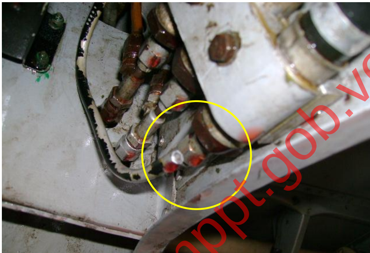
Detalle de la línea hidráulica rota.
