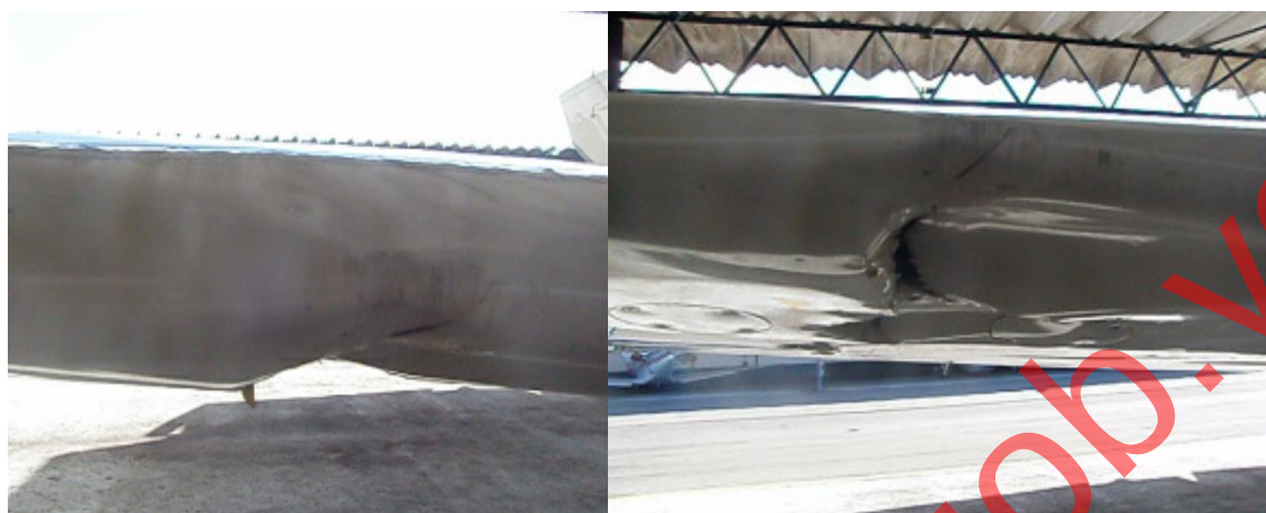
Fotografía 2. Daños por perforación en el intradós del plano derecho.
