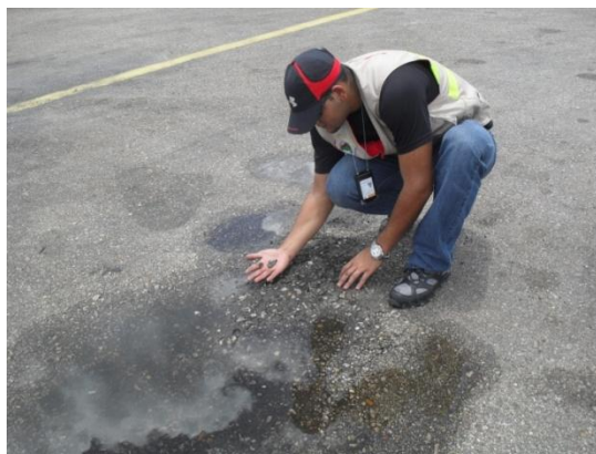
Fotografía 9. Presencia de FOD y Hundimiento en la Plataforma de Parqueo. Fuente DGPIAAE (2012).
